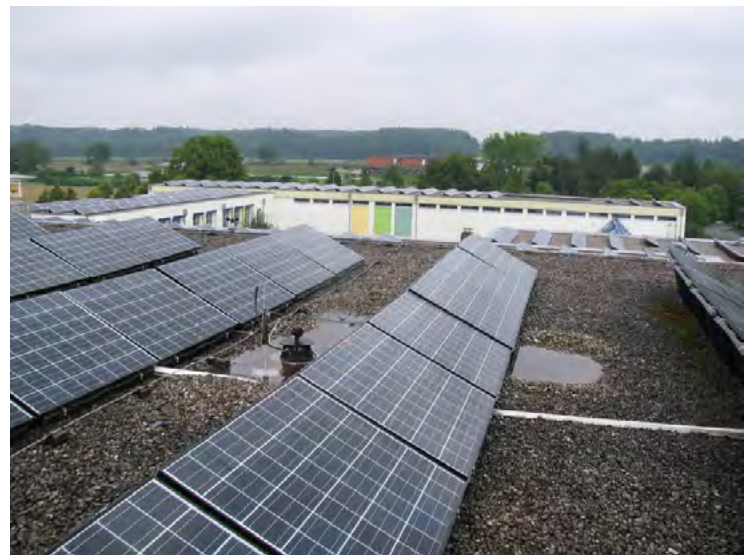
Abb. 360: PV-Module auf den Dächern der Mittelschule und Grundschule Kissing. Quelle: Bürgersolar Kissing e.V.
